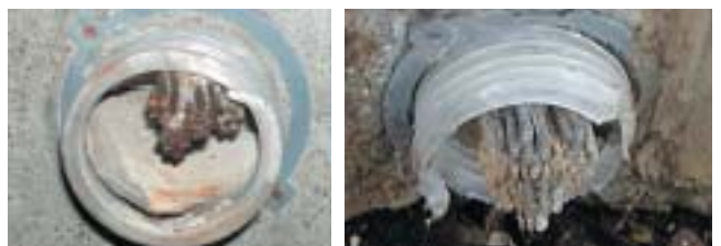
写真-5 PC鋼より線の破断
