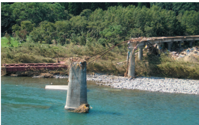
写真-1 高千穂鉄道の落橋状況
