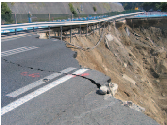
写真-3 山陽道下り線の崩落状況(国土交通省中国地方整備局:提供)
