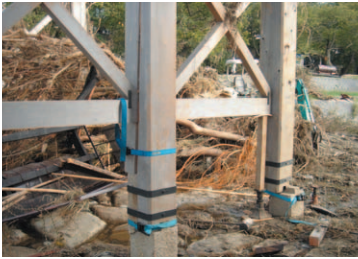
写真-7 錦帯橋第五橋一柱被害状況 （岩国市観光課錦帯橋担当 室：提供）
