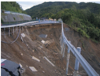
写真-4 山陽道路面からの崩落状況(国土交通省中国地方整備局:提供)
