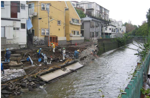
写真-1 妙正寺川北原橋上流右岸護岸損壊写真
