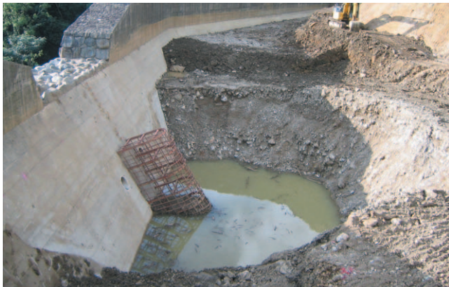
写真-6 五木村頭地代替地田口砂防ダム(土砂の除去中の写真であるが、痕跡から満砂状態になっていたことがわかる)(2006年8月21日撮影)
