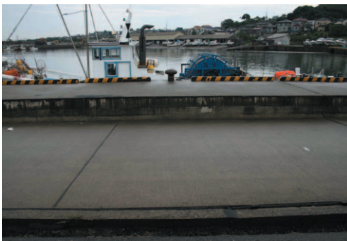
4 岸壁取付け護岸の被害(柏崎港中央埠頭東側岸壁)
