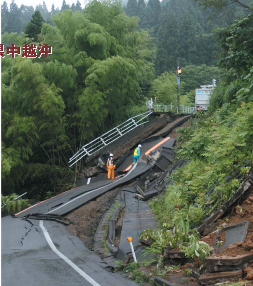
1 土砂崩落に伴う道路の被害（一般国道8号線長岡市大積千本町地先）
