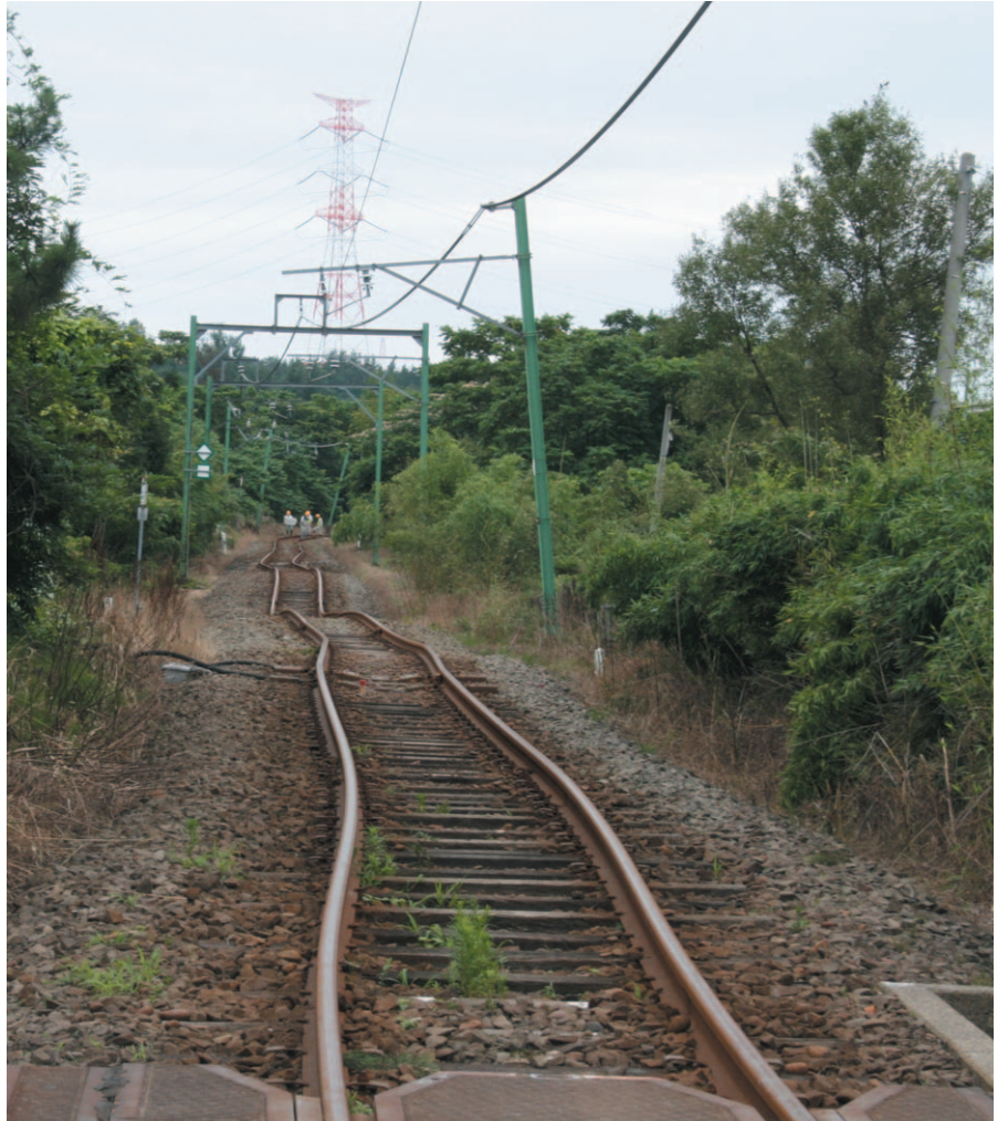
3 地盤の変状に伴う線路の蛇行被害(越後線西中通り駅南側)
