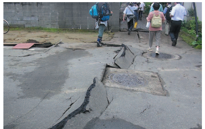
写真-2 砂丘麓部分の圧縮痕
