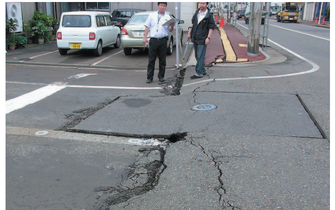
写真-1 馬の背状の砂丘肩部分に現れた亀裂開口
