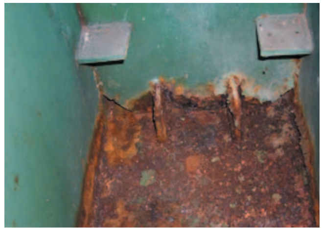
写真-7 トラス主構斜材ダイヤフラムの腐食 10)
