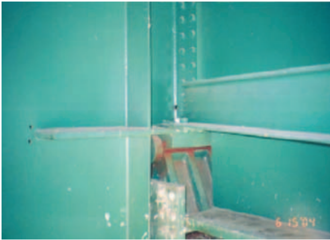
写真-6 北側端横桁ウェブ補剛材の亀裂 10)
