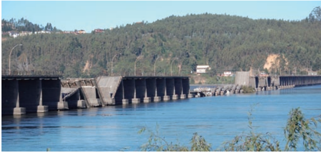
写真4 旧ビオビオ川橋の落橋。1990年代のJICAの調査で、継続使用は不適当と判断されていた
