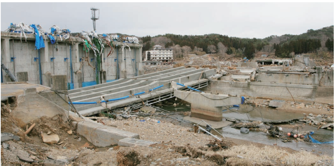
橋梁の被災(田老地区みなと橋)
