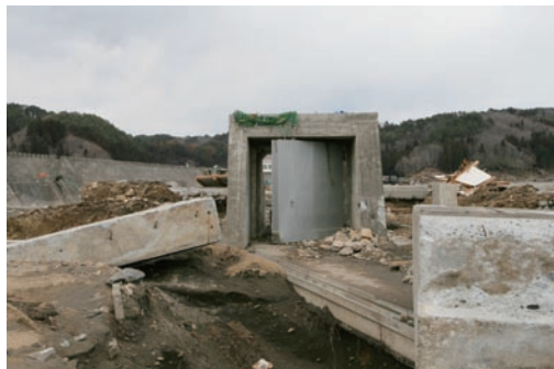
防潮扉・防潮堤の被災 (田老地区)
