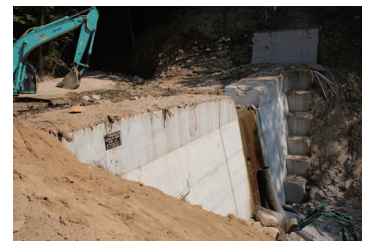
写真6 梅河団地被災状況(上: 写真の右側(治山ダム方向)から土石流が押し寄せる。下: 土砂で埋まった治山ダム)
