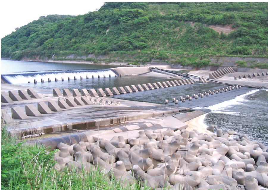
分水路河口付近にある第二床固とバフルピア
