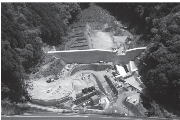
写真2 「残存型枠工法」を用いた施工の様子 (中野東地区〔広島市安芸区]) (提供: 国土交通省)
