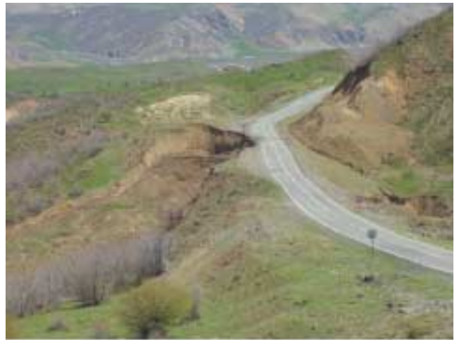
写真-1 ハイウェイにおける斜面崩壊
