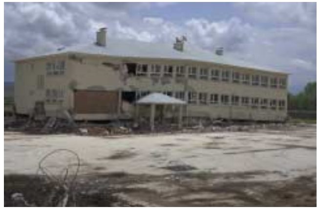
写真-5 Eltiksuu小学校の校舎の倒壊
