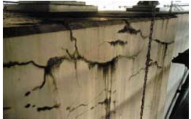
写真-1 鉄筋破断した構造物のひび割れの例
