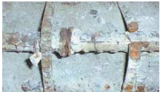
写真-2 破断した鉄筋の例（表面コンクリートを取り去った状況）
