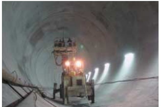
写真-3 発電用水路（コンクリートライニング部）
