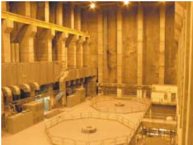
写真-5 半地下式発電所（奥から3号機，2号機）
