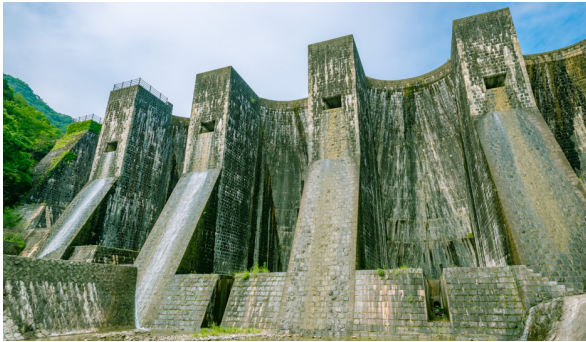
豊稔池堰堤の“術後の経過写真”
