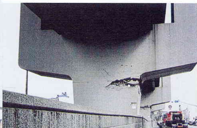
H 2 段落とし部における鉄筋降伏
