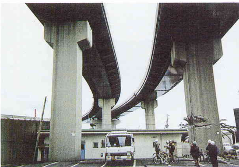
H 7 高さの高い単柱式橋脚の被害 段落とし部での鉄筋降伏
