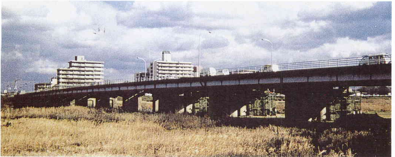
S 1 2 軽微な被害の国道 171 号線の橋脚
