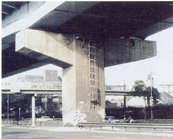
K 5 矩形断面の橋脚 曲げ降伏
