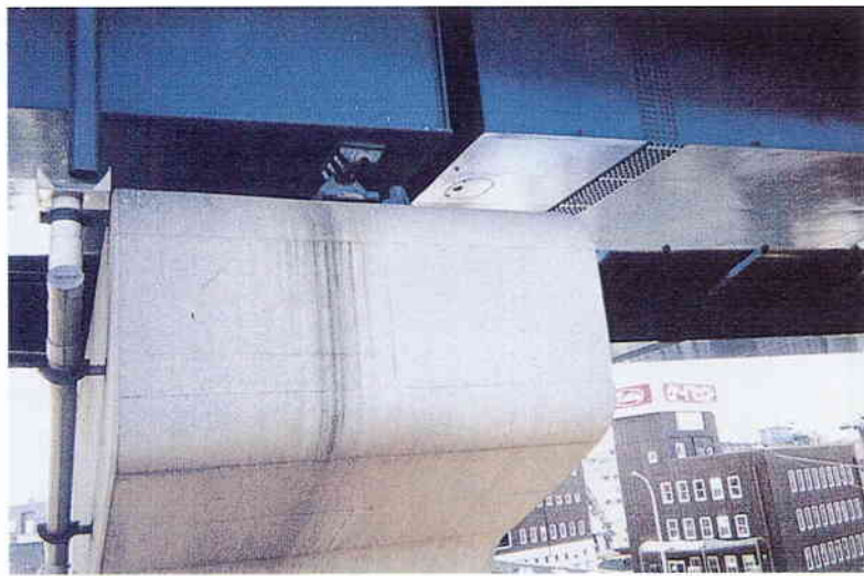
H 1 3 支承上における鋼桁の横ずれ
