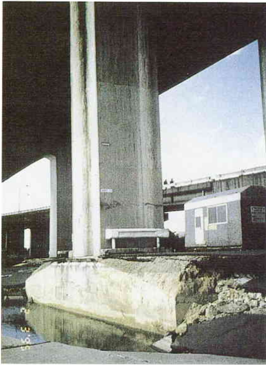
H 9 健全なフーチング 周囲の土は陥没
