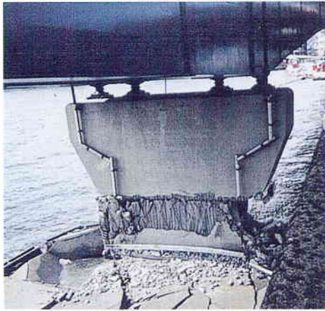
H 1 4 水平打継目と鉄筋破断
