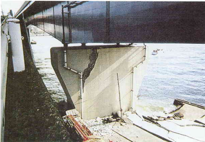
H 1 2 第二摩耶大橋の橋脚に見られた 奇妙なひびわれ
