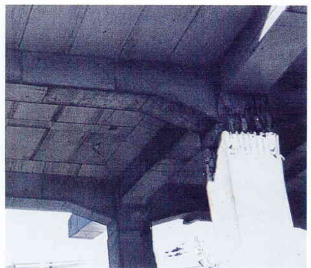
S 5 曲げ降伏後のせん断ひびわれ
