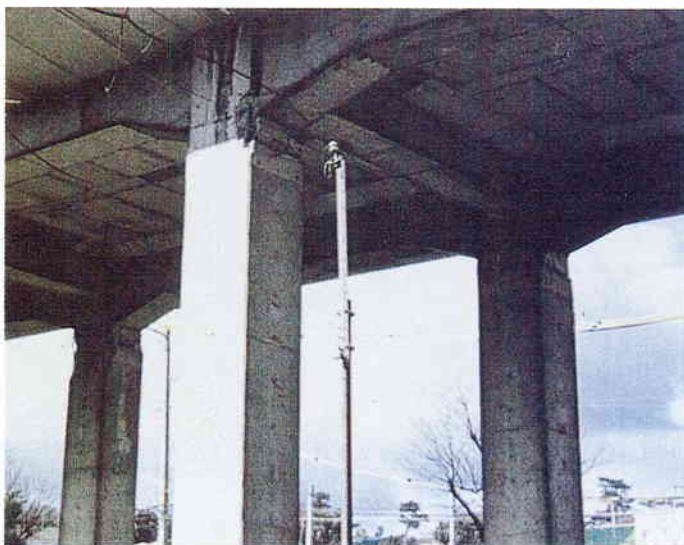
S 4 中間ばりを有しないラーメン高架橋 ハンチ直下での曲げ降伏
