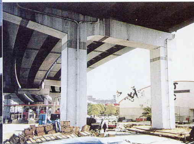
H 1 7 鋼橋脚に見られた亀裂
