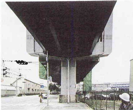
H 5 局部座屈の認められた鋼橋脚
