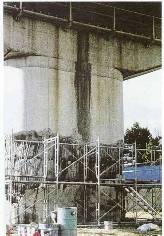
S 10 段落とし部における 鉄筋の曲げ降伏後の局部座屈 かぶりコンクリートの剥落 ばらけた帯鉄筋 真ん中に水平打継目
