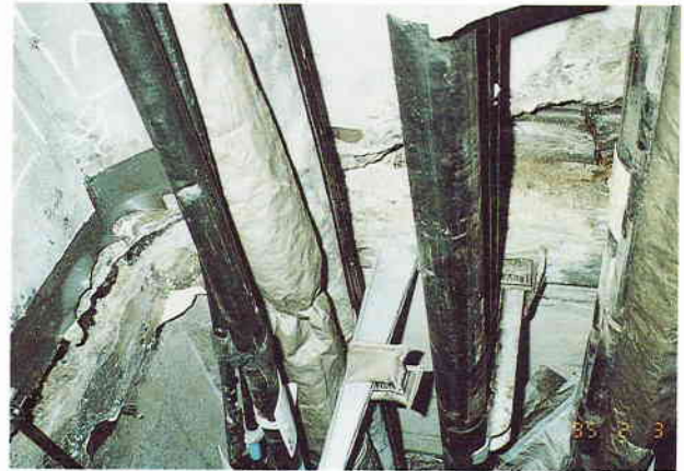
写真-7 エキスパンションジョイント部の 開口破損状況
