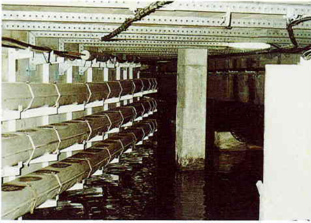
写真-5 共同溝湧水による浸水状況
