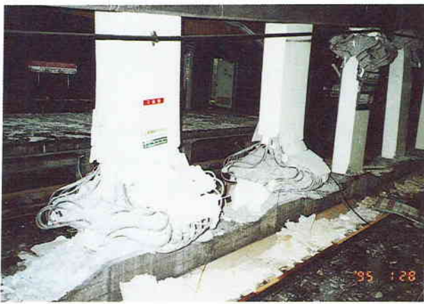
写真-3 大開駅地下2階の被害状況（三宮方面側）
