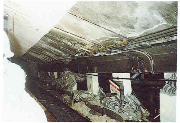
写真-2 大開駅地下2階の被害状況（長田方面側）
