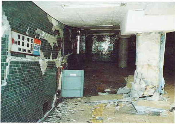
写真-1 大開駅地下1階の被害状況
