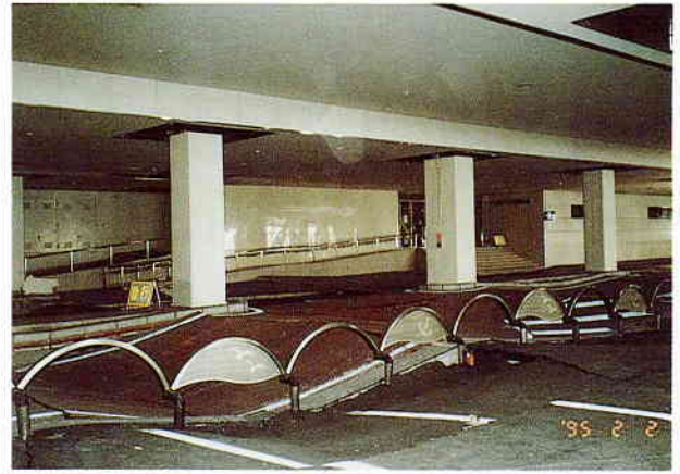
写真-6 共同溝敷設上部付近駐車場の被害状況
