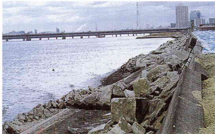
写真-11 淀川堤防の被災状況
