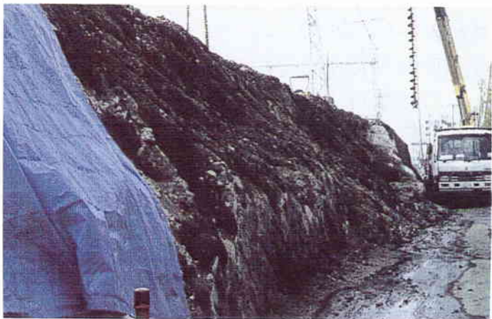
写真-8 摂津本山駅付近の盛土崩壊状況
