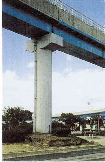
写真-2 基礎の浮き上がり
