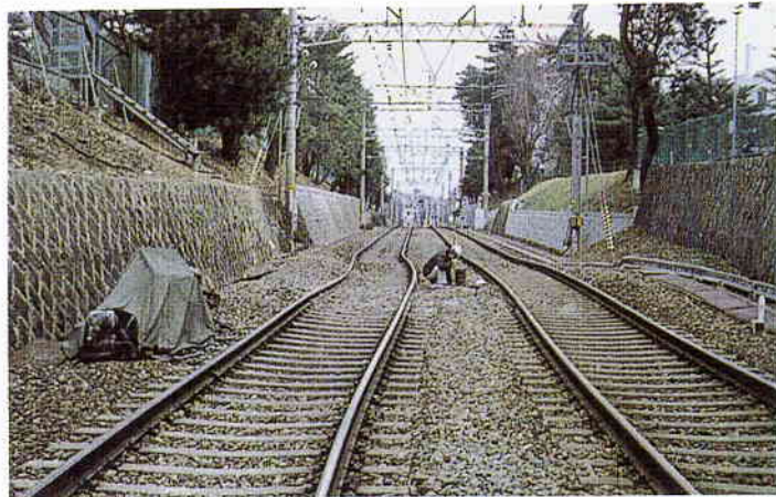
写真-10 岩園町の地すべり状況
