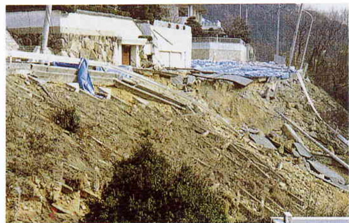
写真-6 西岡本七丁目の斜面崩壊状況
