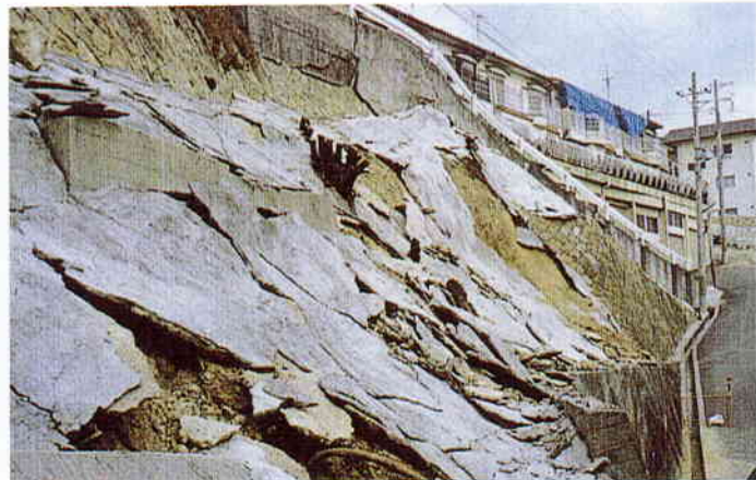
写真-5 コンクリート吹付け工の破壊状況
