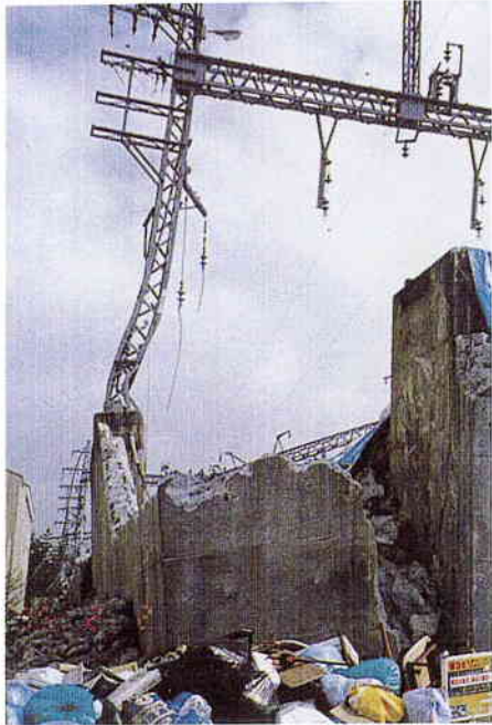
写真-9 石屋川駅の盛土崩壊
