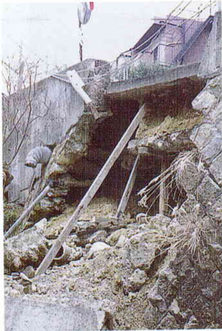
写真-4 岡本六丁目盛土崩壊
