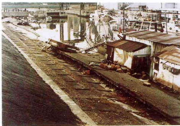
(a) 裏のりの崩壊(滑り)
