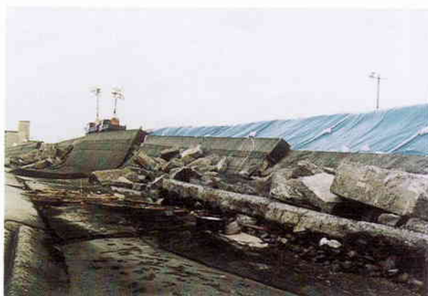
(a) 特殊堤の崩壊
