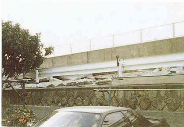
写真3 正蓮寺川(天端の破損)
