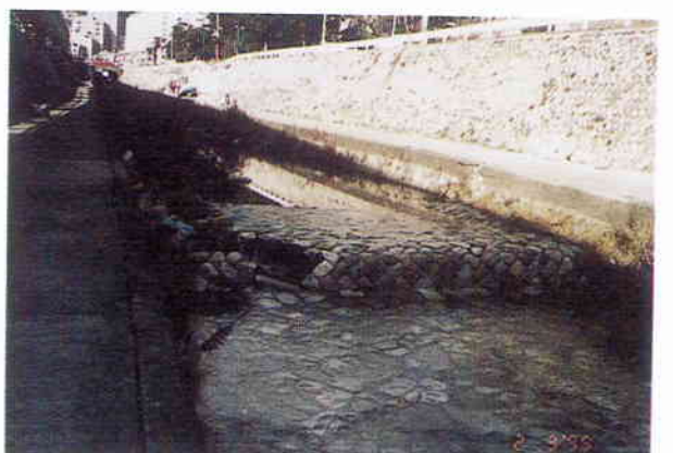
(b) 低水護岸、床止め工の破損
