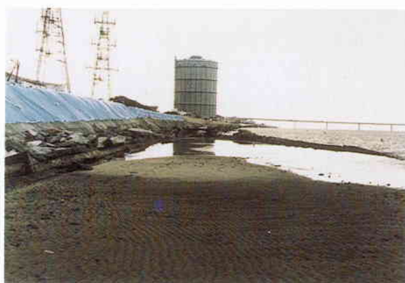
(d) 堤体内からの土砂の流出
