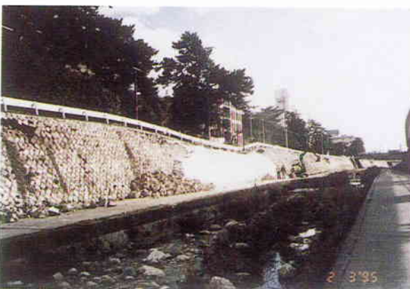
(a) 石積み護岸の崩落
