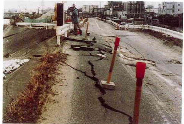
写真4 神崎川(天端の亀裂、沈下)
