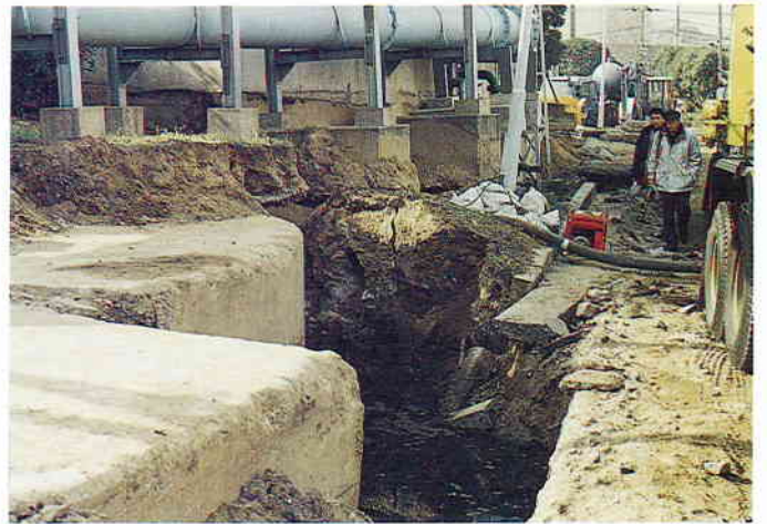
写真 - 4 東灘下水処理場の被災現場
