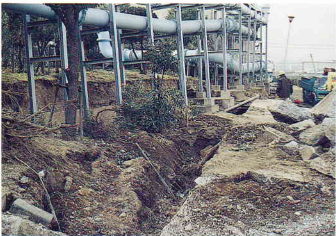
写真 - 5 東灘下水処理場の被災現場
