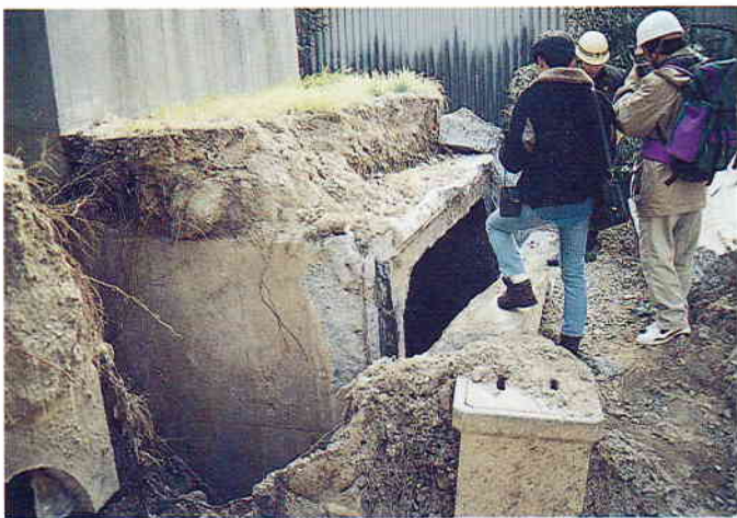
写真 - 3 東灘下水処理場の被災現場
