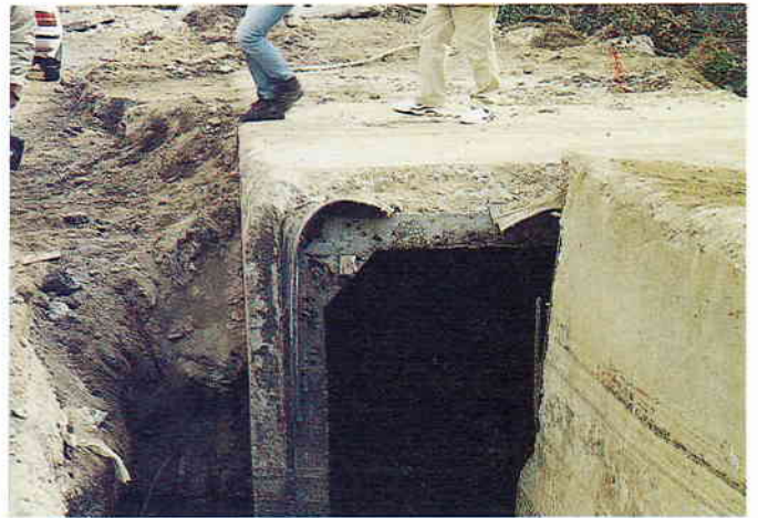
写真 - 2 東灘下水処理場の被災現場
