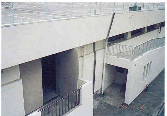
写真-12 ポートアイランド下水処理場
