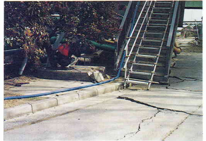
写真 - 6 東灘下水処理場の被災現場
