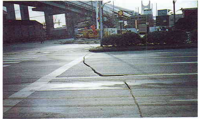
写真4 交差点周辺のひびわれ（その1）
