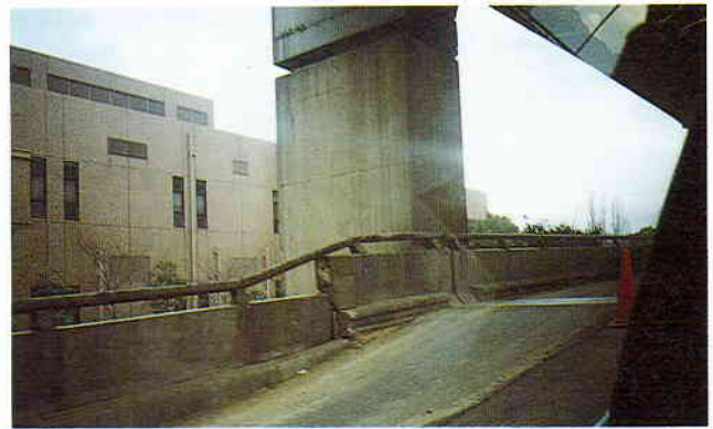
写真2 路面の波状変形（その1）
