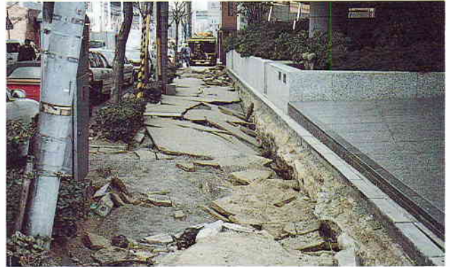
写真6 歩道舗装の破損（その1）
