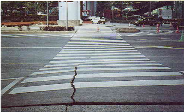
写真5 交差点周辺のひびわれ（その2）
