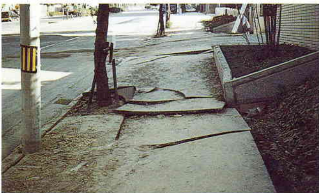
写真7 歩道舗装の破損（その2）
