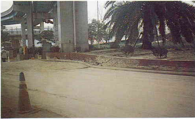
写真3 路面の波状変形（その2）
