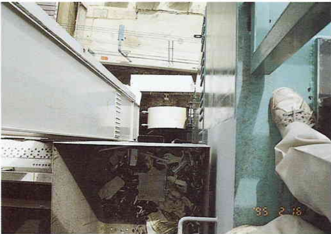
写真 13 東神戸大橋の支承の損傷
