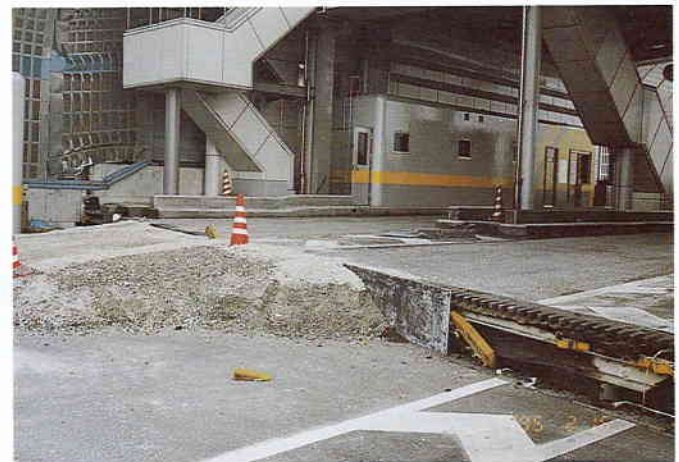
写真 10 南芦屋浜料金所付近の路面の段差
