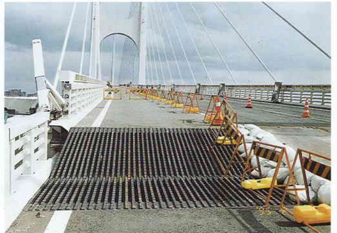
写真 14 東神戸大橋の路面の段差
