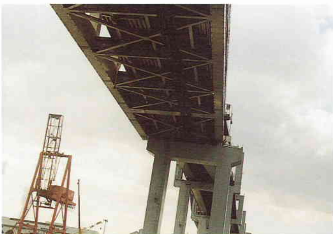
写真 15 六甲アイランド大橋の橋軸直角方向の移動
