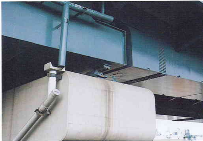
写真 19 第 2 摩耶大橋の支承の損傷
