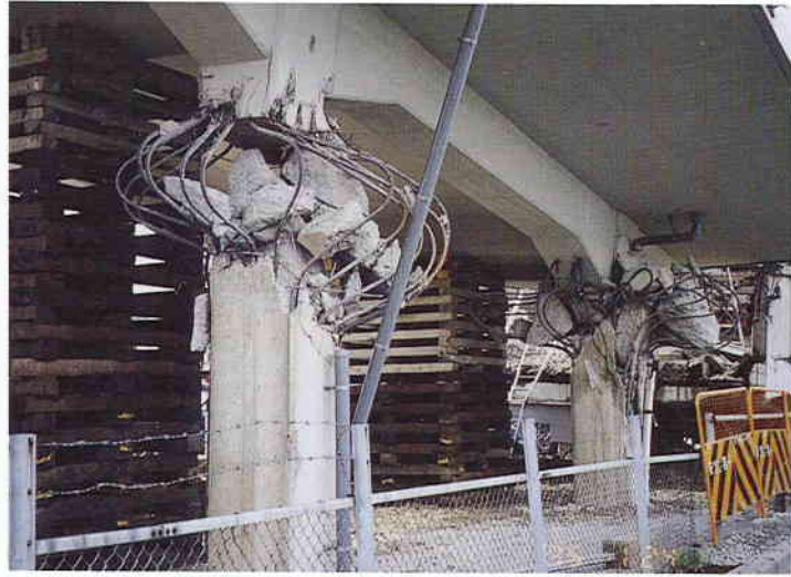
写真-2 写真-1の状態が進行してずれ落ちた状態
