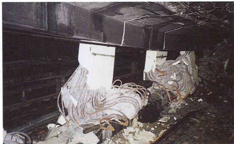
写真-5 写真-4の状態が進行してずれ落ちた状態
