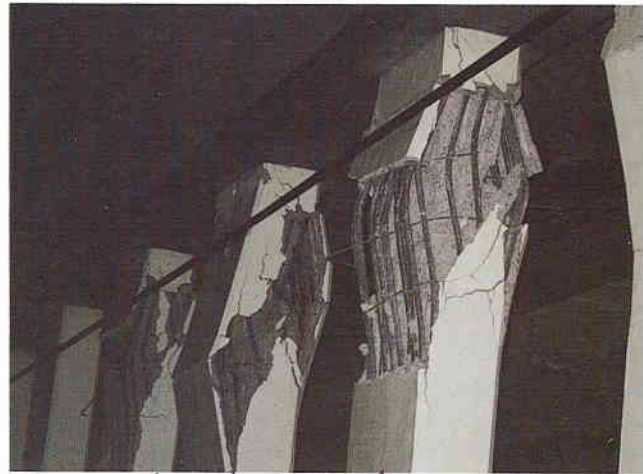
写真-4 矢印の先の柱がこの方向の面でせん断破壊している。
