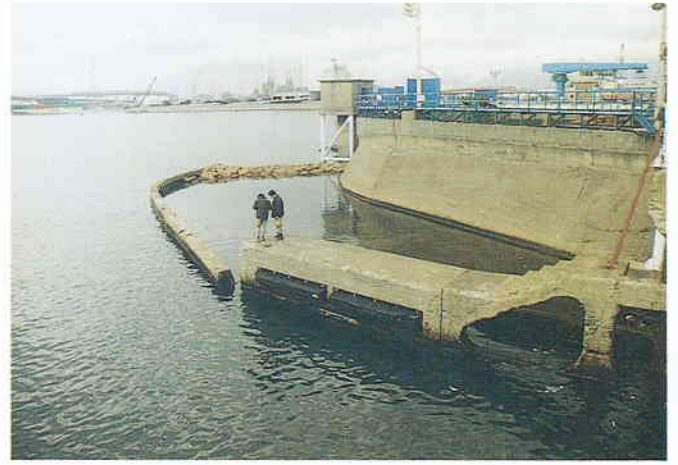
写真-2 液状化による尼崎閘門付近の沈下
