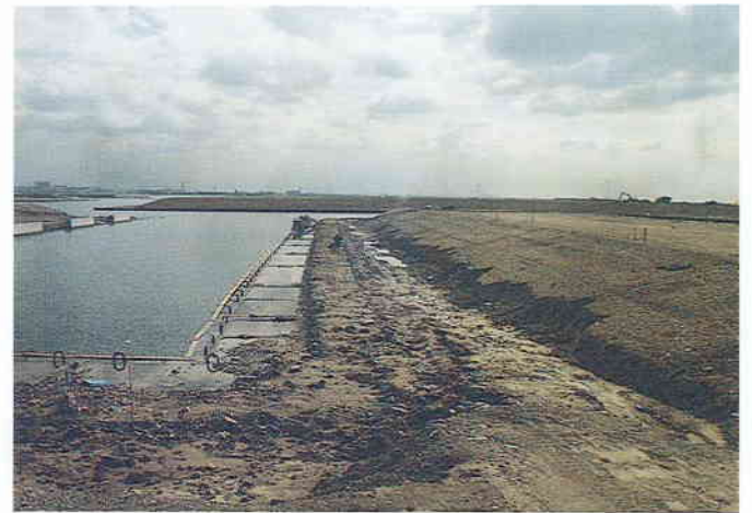
写真-4 南芦屋浜埋立地における護岸沈下（護岸形式B）
