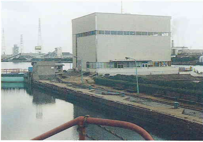
写真-1 尼崎閘門構造物付近の液状化
