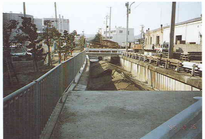
写真-12 長田港近傍人工河川の河床破壊
