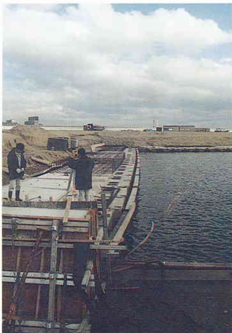
写真-5 南芦屋浜埋立地における護岸水平移動（護岸形式B）
