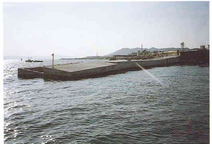
写真-10 長田港防波堤の傾斜・沈下
