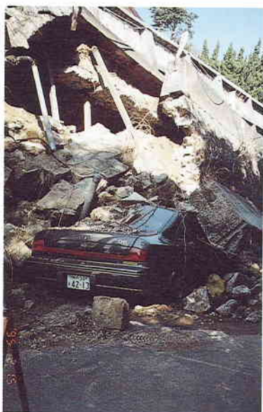
写真-3 石積み擁壁の倒壊
