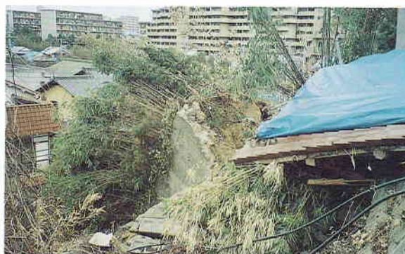
写真-6 コンクリート擁壁の転倒
