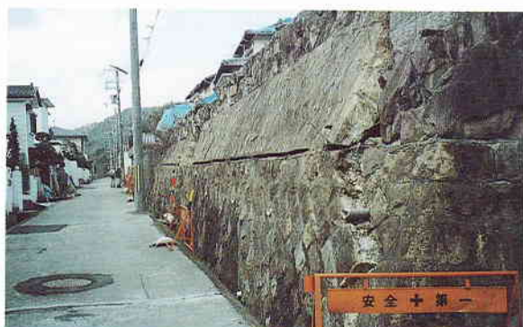
写真-5 二段積み擁壁のはらみ
