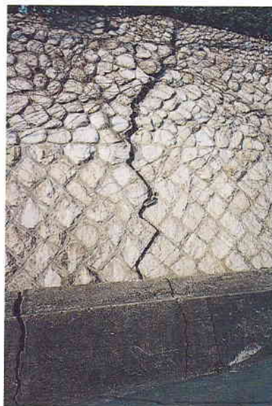
写真-4 石積み擁壁の縦方向亀裂
