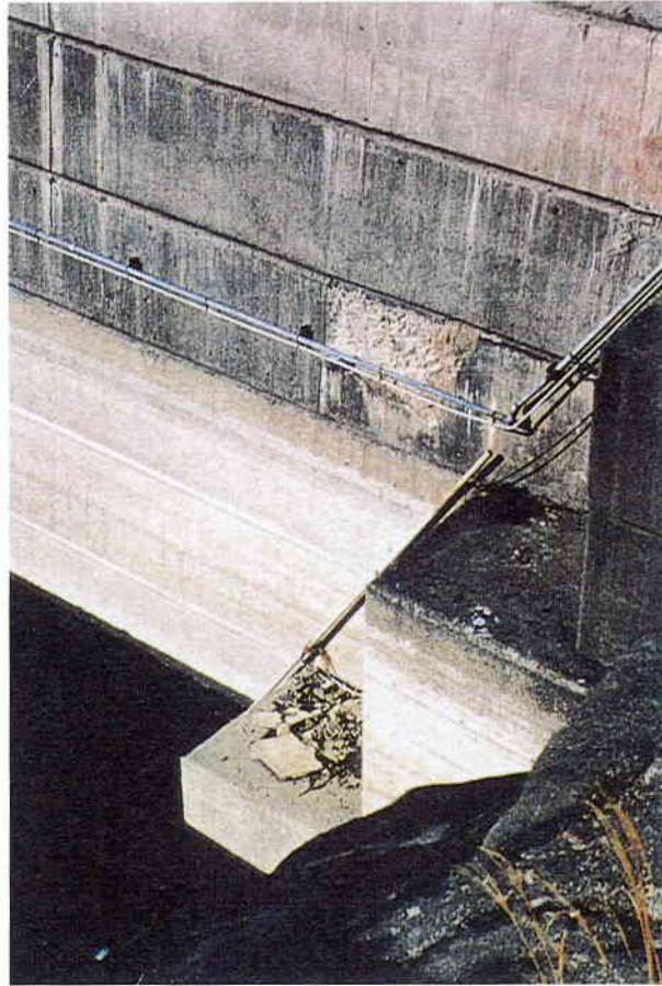
モルタルの剥離状況
