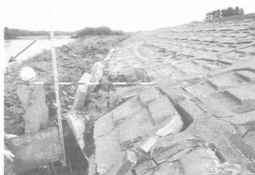
写真 6.3.4 (後志利別川) 鈴金その 3 地先護岸被災状況
