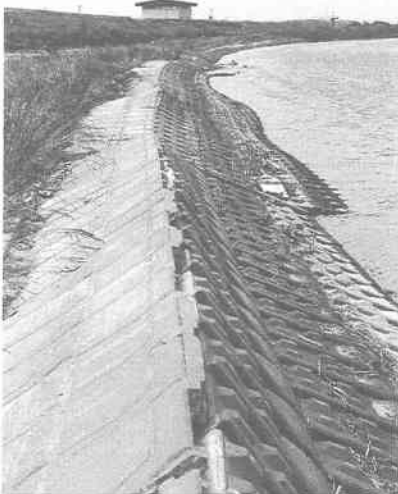
写真 6.3.1 （後志利別川） 兜野築堤左岸護岸被災状況
