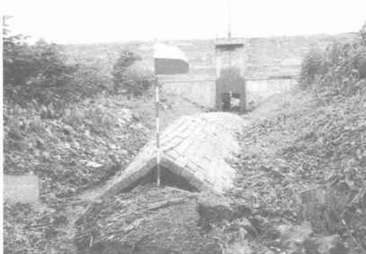
写真 6.3.3 (後志利別川) 神丘地先右岸 (樋門) 護岸被災状況
