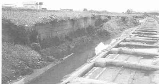
写真 6.3.5 (2 級河川 大野川) 大野川護岸被災状況
