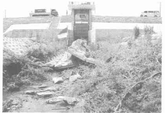
写真 6.3.2 （後志利別川） 兜野築堤左岸（樋門）護岸被災状況
