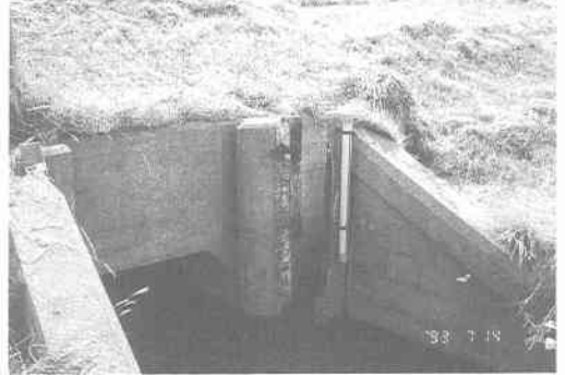
写真 6.4.2 (尻別川) 被災後の翼壁部の開口状況
