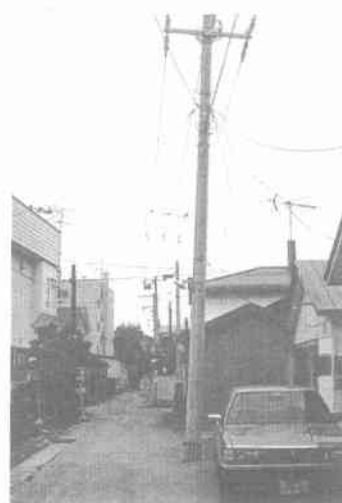
写真 11.2.5 地盤の液状化による電柱の埋没 (七重浜)
