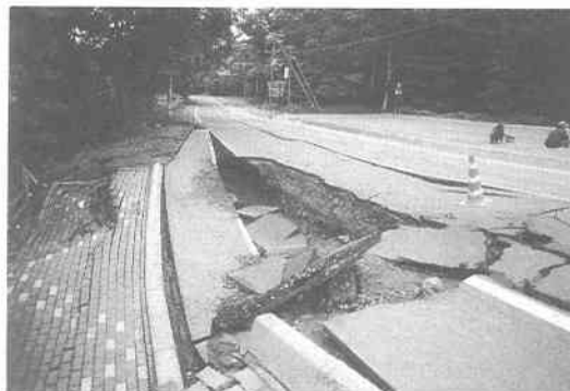
写真 11.1.1 陥没による直管部の破損
