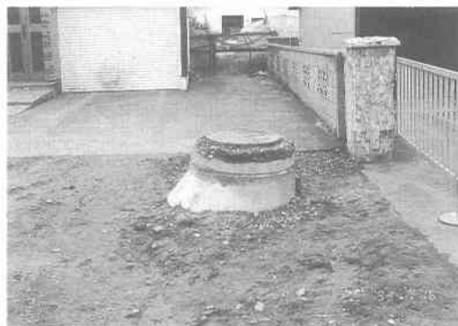
写真 11.1.2 下水マンホールの浮上
