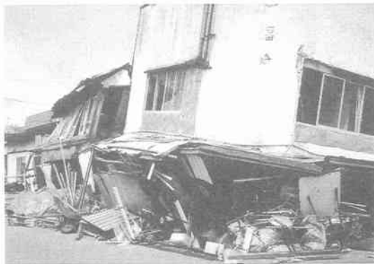
写真 12.4.11 木古内町木古内、木造店舗住宅（隣接2面開放型木造建物の倒壊、写真提供：木古内町）
