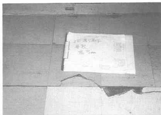
写真 12.3.1 江差町、道立江差病院（RC造4階建て、渡り廊下のひび割れ）
