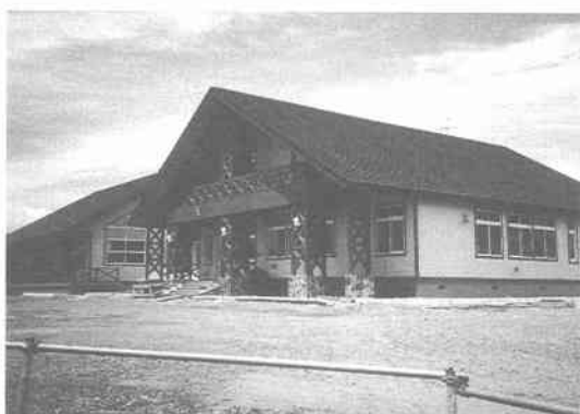
写真 12.5.20 周辺地盤の液状化による地盤沈下による被害を受けた八雲町立山崎小学校（撮影：宮澤健二氏）
