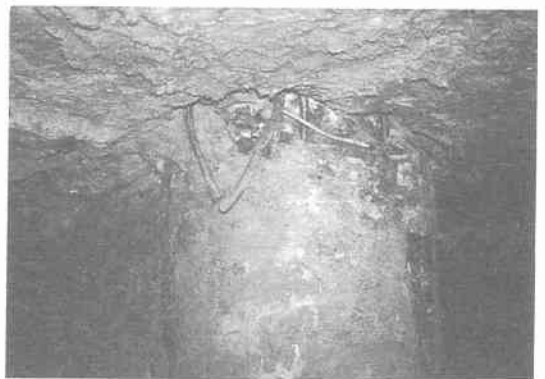
写真 12.2.14 青苗小学校校舎 22) (杭頭が水平移動し, コンクリートが剥離)
