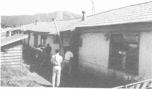
写真 12.4.5 七飯町、ブロック造町営住宅（不同沈下による建物の変形，写真提供：寒研）
