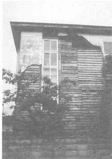
写真 12.2.2 奥尻町役場 20) (東妻面外壁 のモルタルが剥落)
