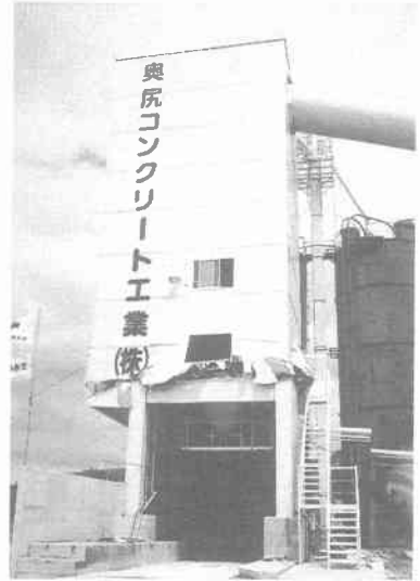
写真 12.2.20 レディミクストコンクリート工場 20) （バッチャープラントが傾斜）
