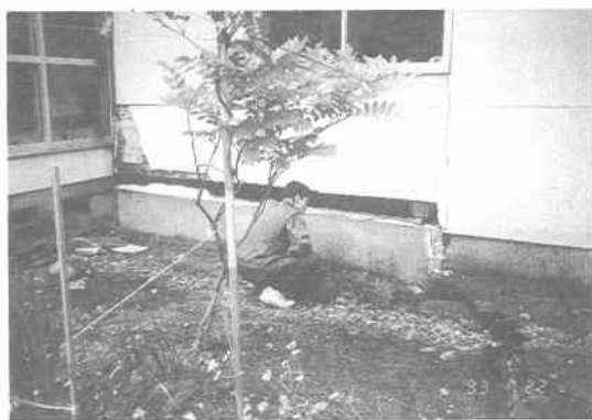
写真 12.3.6 乙部町、乙部保育所（木造平屋建、無筋コンクリート基礎の破断）
