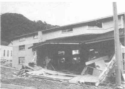
写真 12.3.23 島牧村栄磯 (倉庫, 津波による破損, 写真提供: 城攻氏)
