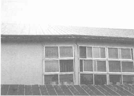
写真 12.3.4 江差町，朝日小中学校（木造2階建て， 体育館外壁のひび割れと開口部の変形， 写真提供：井野智氏）
