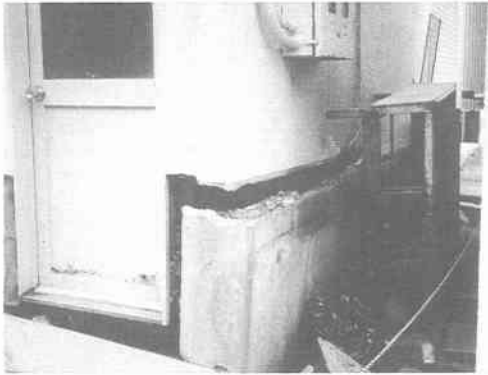
写真 12.4.3 函館市若松町，ビジネスホテル（地盤沈下による基礎の破壊，写真提供：道立寒地住宅都市研究所，以下「寒研」と略記）
