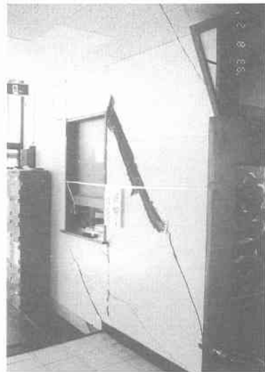
写真 12.2.18 青苗小学校校舎（コンクリートブロック帳壁のせん断破壊）
