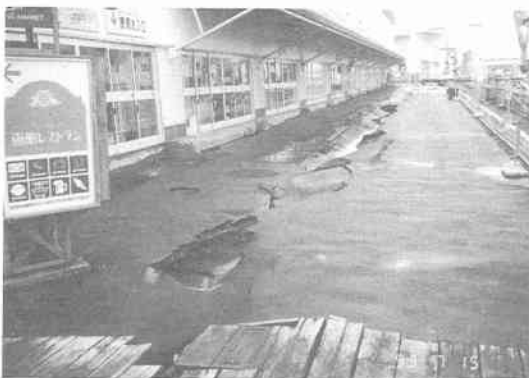
写真12.4.1 函館市若松町，シーポートプラザ （周辺地盤の沈下）
