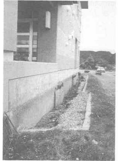
写真 12.3.3 江差町，水堀小中学校（RC造2階建て， 校舎周辺地盤の沈下，写真提供：井野智氏）
