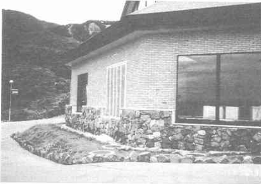
写真 12.2.27 ホテル建物 21) (ボイラー煙突の傾斜)
