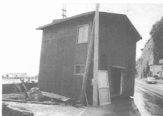
写真 12.3.26 神恵内村（木造2階建て住宅、 津波による建物のずれ）
