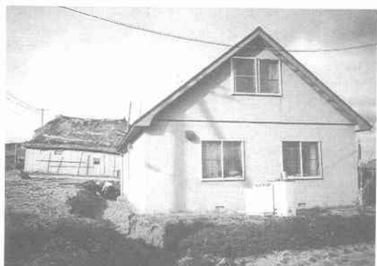
写真 12.3.17 北檜山町兜野 (CB造住宅， 液状化による住宅の沈下)
