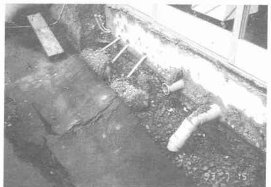
写真12.4.2 函館市若松町，シーポートプラザ （周辺地盤の沈下と地下埋設管の破損）
