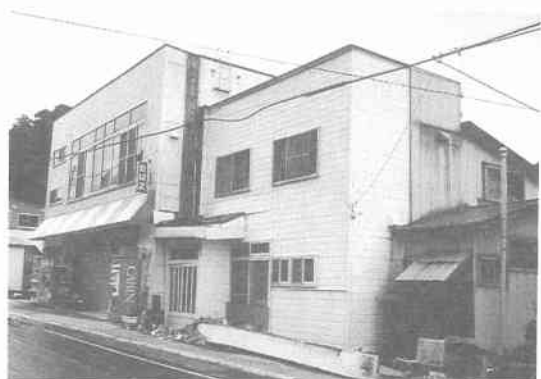
写真 12.2.4 店舗併用住宅 20) (集合煙突が外壁から外れて倒壊)
