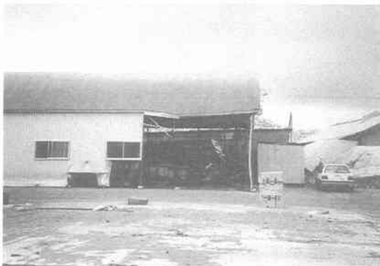
写真 12.3.20 瀬棚町本町 (S造倉庫, 津波による破損, 写真提供: 瀬戸口剛氏)
