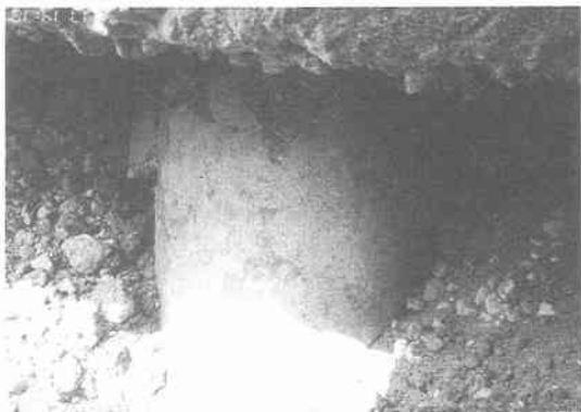
写真 12.5.5 杭頭の破壊 (中の沢小)
