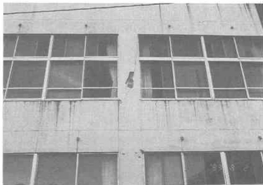
写真 12.2.12 青苗小学校校舎 (2 階柱にひび割れ, 1 階柱頭端部に圧壊)
