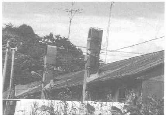
写真 12.5.11 煙突のひび割れと傾斜 (神社下公営住宅団地)
