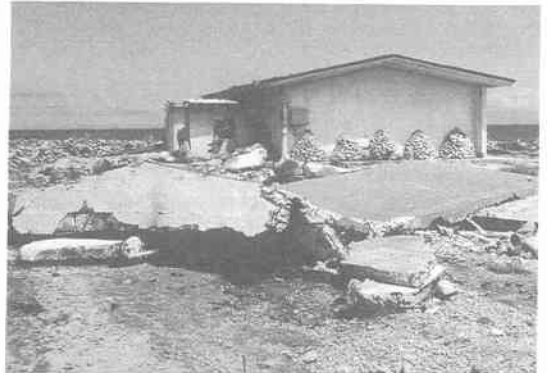
写真 12.2.28 賽の河原地蔵堂 (2棟の建物の1棟が津波によって押し流されている)
