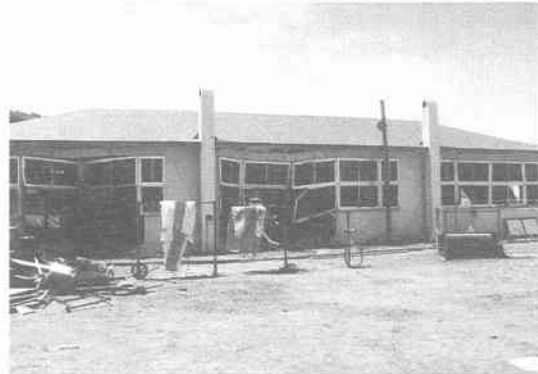
写真 12.2.26 稲穂小学校 (津波により壁面が押しつぶされる)
