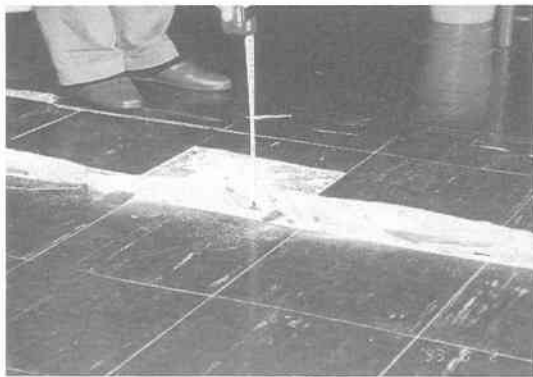
写真 12.2.17 青苗小学校校舎（1階床の土間コンクリートが沈下）
