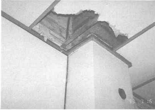
写真 12.3.2 江差町，日明小中学校（木造2階建て， 集合煙突が破損し室内に落下，写真提供：井野智氏）
