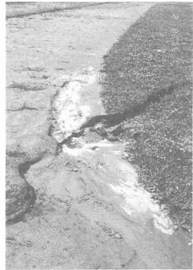
写真 12.2.13 青苗小学校グラウンド (地割れおよび噴砂の跡)
