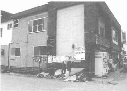
写真 12.2.3 店舗併用住宅 (外壁のモルタルが剥落)
