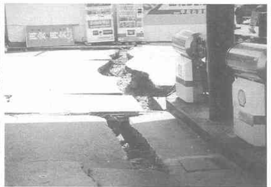
写真 12.5.17 ガソリンスタンドの被害
