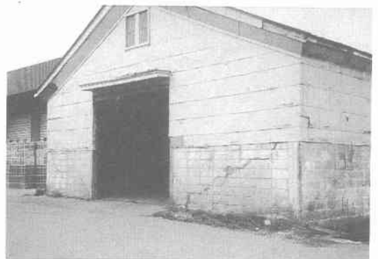
写真 12.3.5 江差町，江差港（CB造漁業倉庫， 壁のせん断ひび割れ）
