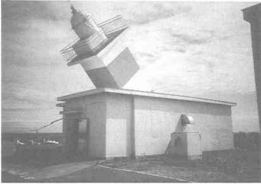
写真 12.2.8 青苗岬灯台 21) (塔部が折れ曲がり傾斜)
