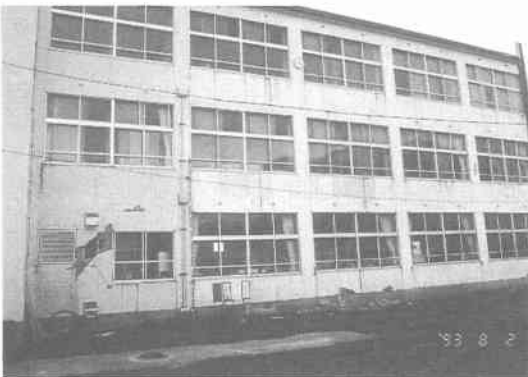
写真 12.2.11 青苗小学校校舎 (北西面の被害状況)
