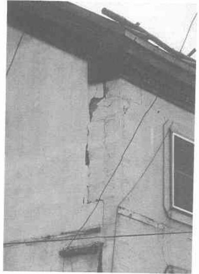
写真12.3.28 小樽市色内（石造倉庫、外壁のひび割れ、モルタルの剥落、写真提供：城攻氏）→
