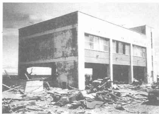
写真 12.2.7 青苗農業協同組合 21) （津波により1階のコンクリートブロック帳壁が破損、構造体の被害は軽微）
