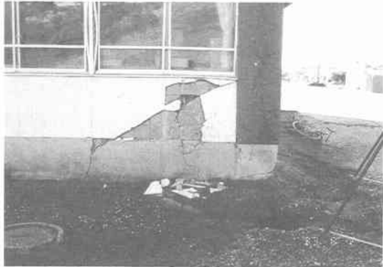
写真 12.2.16 青苗小学校校舎（南西面周辺の地盤沈下，腰壁の破壊）
