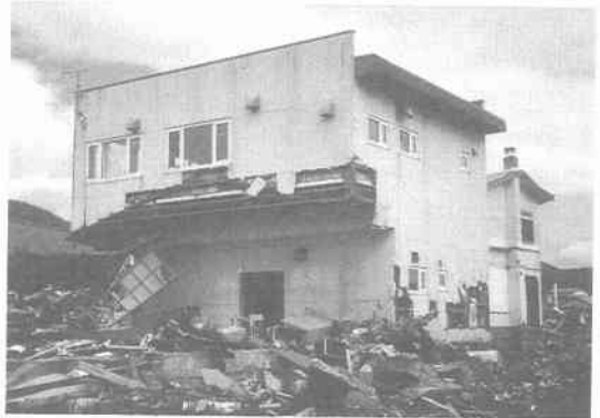
写真 12.2.22 青苗農業協同組合 19) （津波により外壁に損傷、構造体の被害は軽微）
