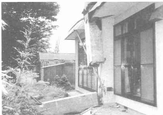
写真 12.4.10 木古内町木古内、木造住宅 （RC造集合煙突の折損）
