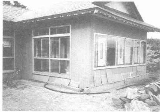
写真 12.3.19 北桧山町下中村(無筋ブロック基礎の破断と躯体のずれ)
