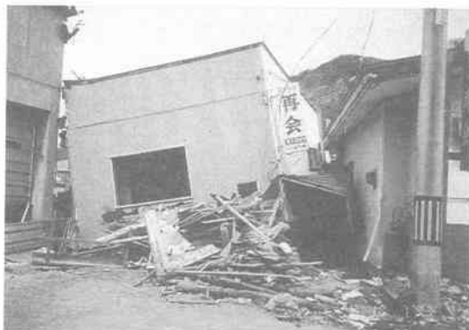
写真 12.3.21 瀬棚町本町 (木造2階建住宅, 津波による倒壊)
