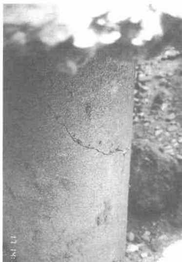
写真 12.5.4 杭頭のせん断ひび割れ (中の沢小)
