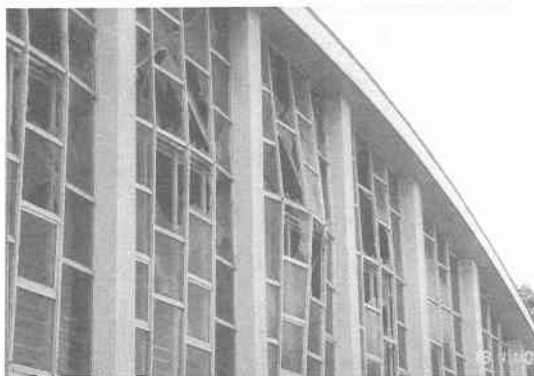
写真 12.5.14 スポーツセンター東側面のガラスの破損状況
