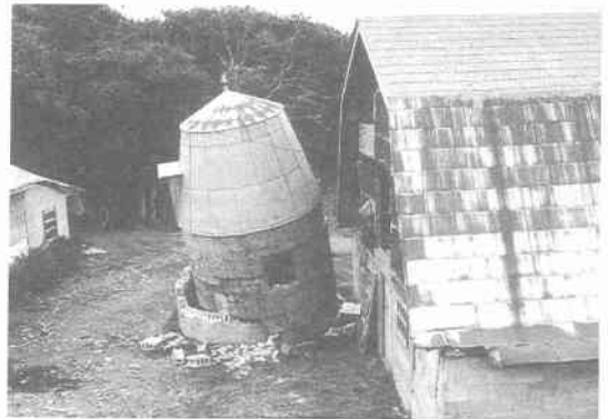
写真 12.2.29 サイロ 20) (無筋コンクリートブロック造のサイロ、下部がせん断破壊)
