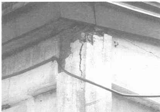
写真 12.5.12 柱・梁接合部の被害(陣屋町公営住宅団地)
