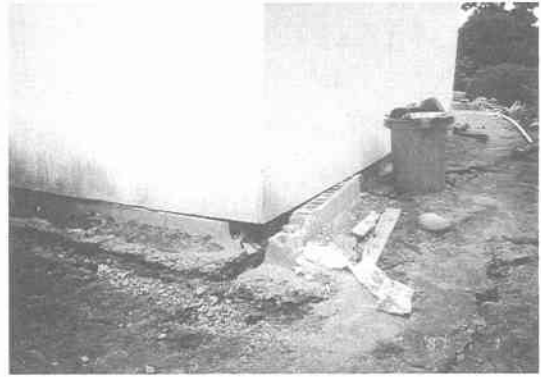
写真 12.3.30 今金町 (無筋ブロック基礎の破断と建物のずれ)
