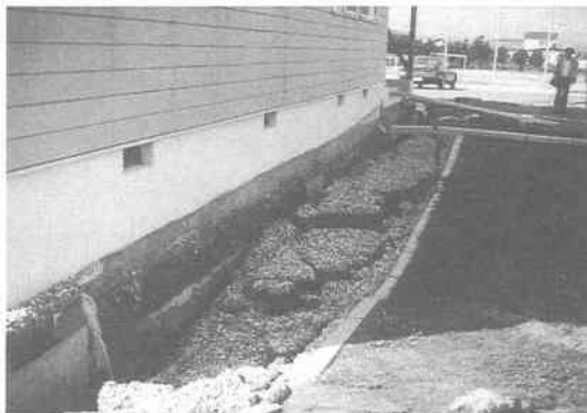
写真 12.5.2 校舎横の地盤沈下による基礎梁の露出 (中の沢小)
