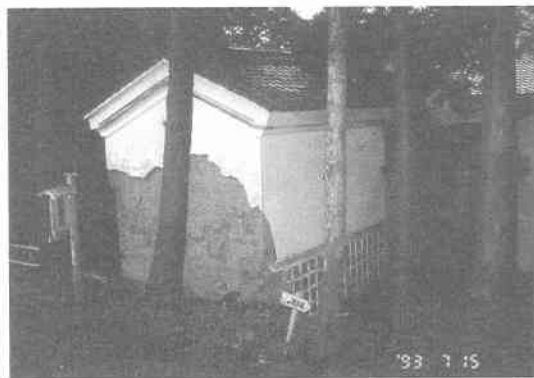
写真 12.4.12 松前町松城、法源寺 （土蔵の外壁漆喰の剥落）
