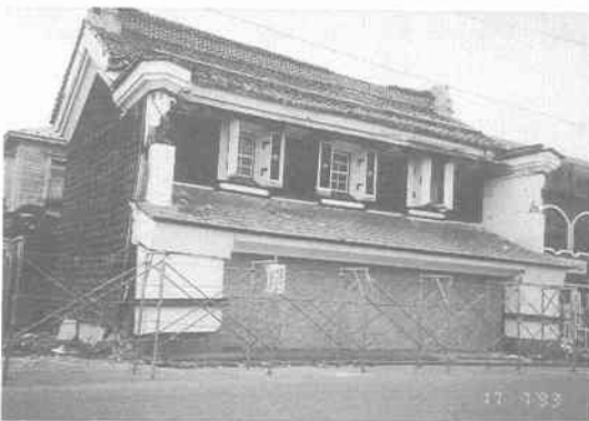
写真 12.4.8 上磯町中央、土蔵付き店舗（1階店舗部分の柱折損と妻壁の大変形，写真提供：寒研）
