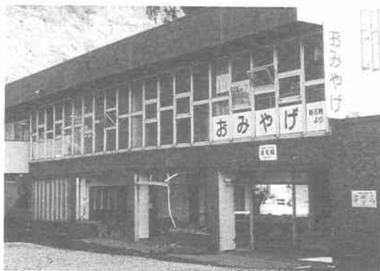
写真 12.2.5 奥尻港フェリーターミナル（津波により窓ガラスが損傷、不同沈下により港湾側に傾斜）
