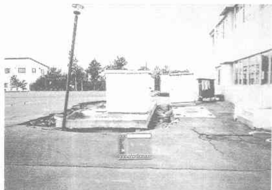
写真 12.3.15 北檜山町，農業環境改善センター (RC 造2階，浄化槽の破損被害，写真提供：北檜山町)
