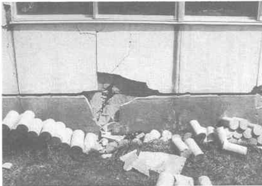
写真 12.2.15 青苗小学校校舎（基礎梁に著しいひび割れ）
