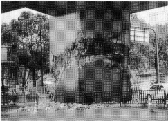
写真 1. 1. 2-3 R C橋脚のせん断破壊
