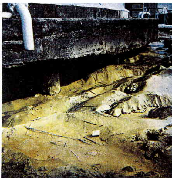
写真-3.1.1 火力発電所（油タンク基礎）の被害例
