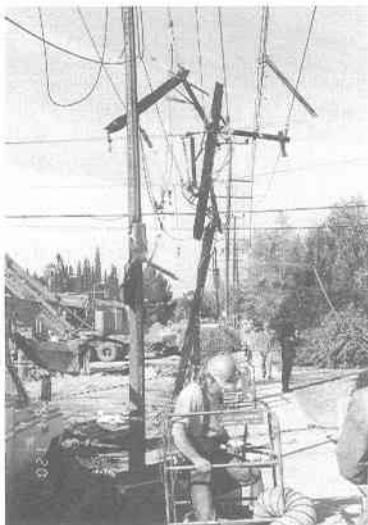
写真 5.5.51 延焼した電柱 2)
