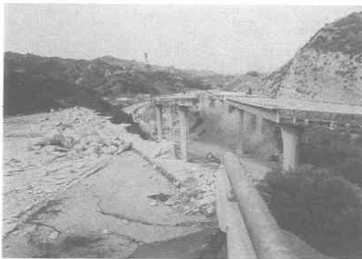
写真 5.5.10 ガビン・キャニオン橋の被害状況 (Caltrans による) (高速道路上から見た落橋箇所の状況。5 径間のうち 2 径間目と 4 径間目の桁が落橋した)
