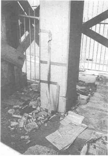
写真 5.5.45 橋脚基部の被害状況（橋脚基部が曲げせん断破壊し、大きなクラックが入っている）
