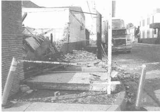
写真 5.5.55 沿道ブロックの歩道側への倒壊 2)
