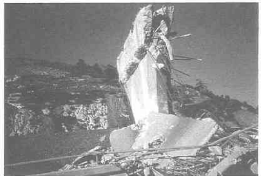
写真5.5.3 特異な被害を生じたP3橋脚（キャップビームと桁を結ぶ鉄筋がほとんど認められない）（EERCによる）
