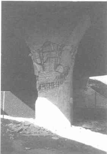
写真 5.5.30 LP2-2 橋脚の被害 (かぶりコンクリートの剥離) (コアコンクリートを拘束する帯鉄筋とは別に、フレアー部を補強する鉄筋が見える) 2)
