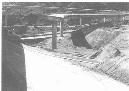
写真 5.5.7 落橋した A1 橋台から P3 橋脚間 2)
