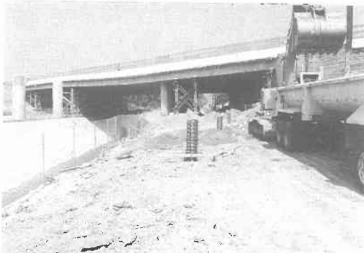
写真 5.5.39 撤去され、新設されつつある東行き橋と仮支持して供用中の西行き橋 1)
