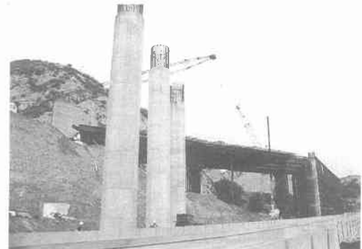
写真 5.5.15 ガビン・キャニオン橋の復旧工事の状況（新設橋脚の工事が完了し、上部のPC桁工事の支保工の組立てが行われていた） 1)
