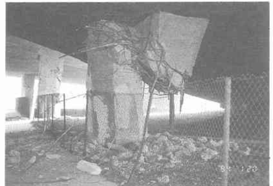
写真 5.5.25 RP2-1 橋脚の被害(軸が完全にずれ、全く耐力を失っている) 2)
