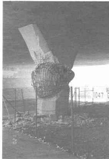
写真 5.5.29 LP3-2 橋脚の被害 (曲げせん断破壊が進み、軸線が完全にずれている) 2)
