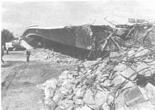
写真 5.5.24 落橋した東行き2径間部分 2)
