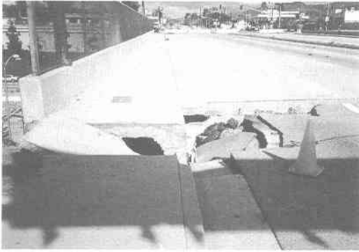
写真 5.5.42 南側 A1 橋台西側の土砂流出による歩道部の陥没
