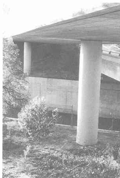
写真 5.5.49 鋼板巻立て工法により耐震補強された RC 橋脚 (I-10 のランプ橋, 被害は全くなかった) 2)
