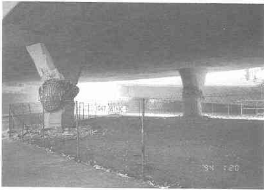
写真 5.5.28 LP3-1 橋脚の被害 (曲げせん断破壊) 2)
