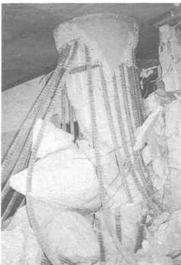
写真 5.5.21 P3 橋脚の被害状況 2)
