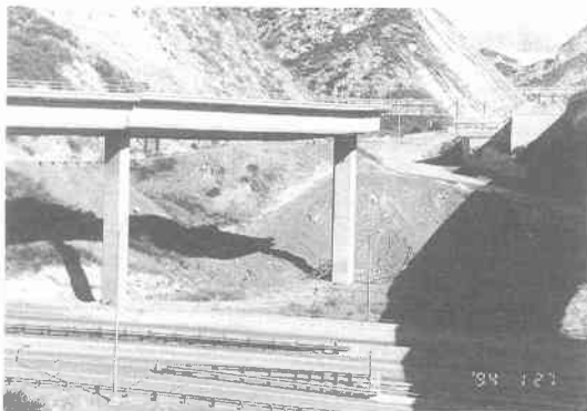
写真 5.5.6 落橋したノースコネクターの A1 橋台から P3 橋脚間（左側の P4 橋脚付近のゲルバーヒンジ部で桁が振動した痕跡がある） 2)
