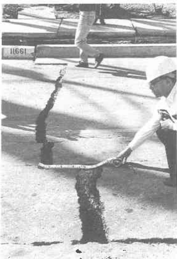
写真 5.5.52 バルボア大通りの路面に 生じたクラック 2)
