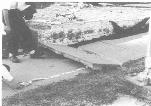
写真 5.5.53 歩道コンクリートブロックの座屈変形 (バルボア大通り) 2)
