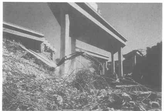
写真 5.5.11 ガビン・キャニオン橋の被害状況 (EERC による) (中央の PC 桁部の状況。南行き、北行きとも被害はなかった。橋脚にも被害は生じていなかった)
