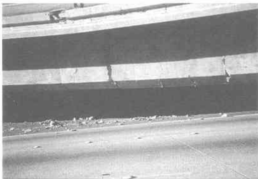
写真5.5.2 P2橋脚付近の上部構造（桁には、正の曲げモーメントによってクラックが入っており、プレストレスが抜けたことを示している。P2橋脚は桁の下で完全に曲げせん断破壊している）（EERCによる）
