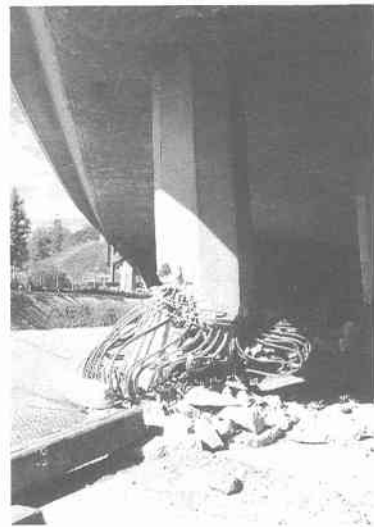
写真 5.5.35 橋脚が完全に外側にはらみだした P3 橋脚 2)
