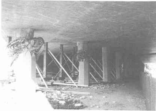
写真 5.5.37 P2 橋脚の被害 2)
