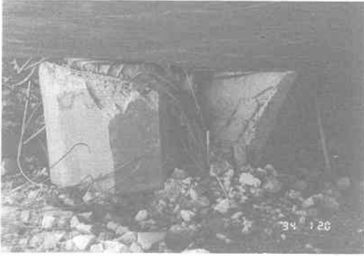
写真 5.5.26 RP3-1 橋脚の被害 2) (フレアーの直下で破壊している)
