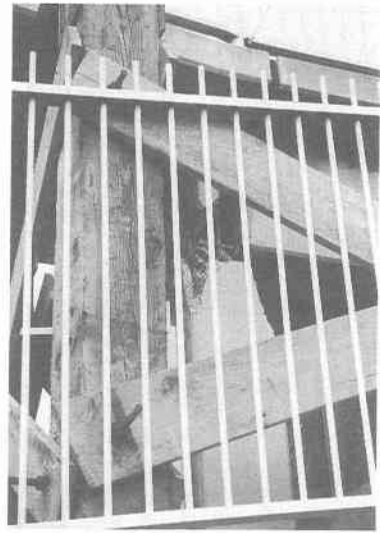
写真 5.5.46 桁端部の被害状況（アンカーバーで固定された桁端部の橋脚コンクリートが完全に破壊している）
