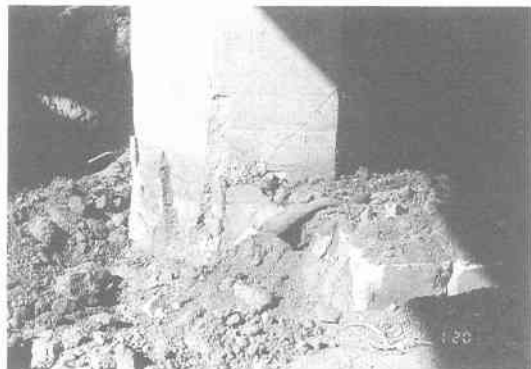
写真 5.5.31 RP2-2 橋脚基礎の損傷 2)
