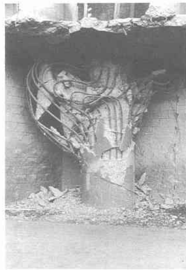
写真 5.5.22 P6 橋脚の被害状況 2)
