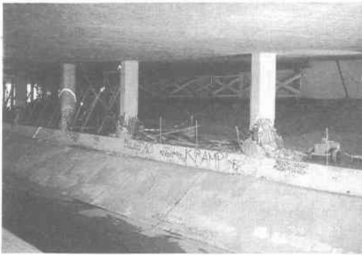
写真 5.5.34 地盤面位置で破壊した P3 橋脚の被害 2)
