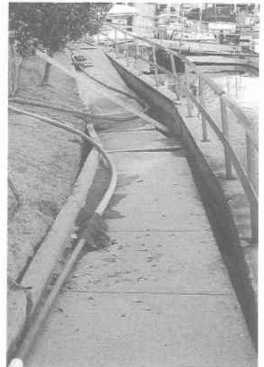
写真 6.4 レドンドビーチの護岸の海側への変位状況
