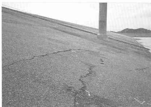
写真 7.3.15 ロサンゼルス貯水池本ダム上流アスファルト ライニングの亀裂 ((株)飛島建設 沼田淳紀氏より提供)
