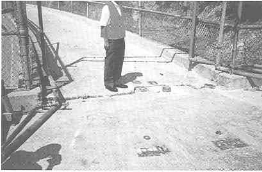
写真 7.3.4 パコイダム左岸アーチ堤体とスラストブロックジョイントの天端での開きおよび段差 ((株)建設技術研究所 荒川昭治氏より提供)
