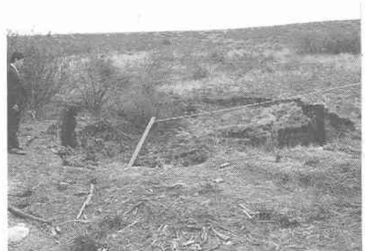
写真 7.3.10 サンフェルナンド下ダム法先付近の埋設コルゲート管上の陥没穴 (東京工大 川島一彦教授より提供)
