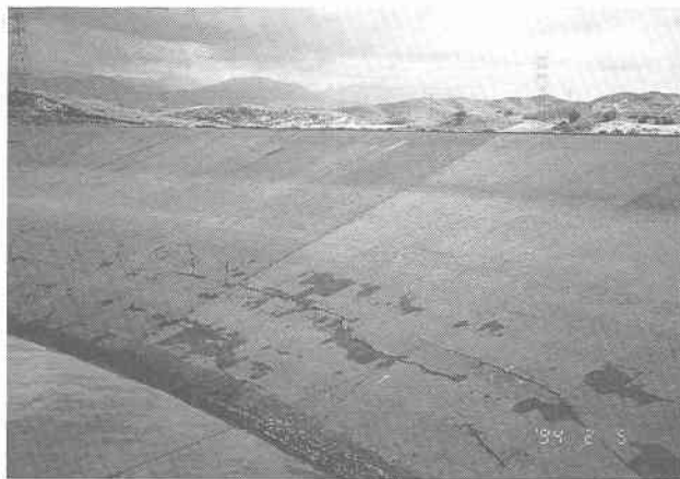
写真 7.3.14 ロサンゼルス貯水池本ダム上流アスファルトライニングの亀裂状況 ((株)飛島建設 沼田淳紀氏より提供)
