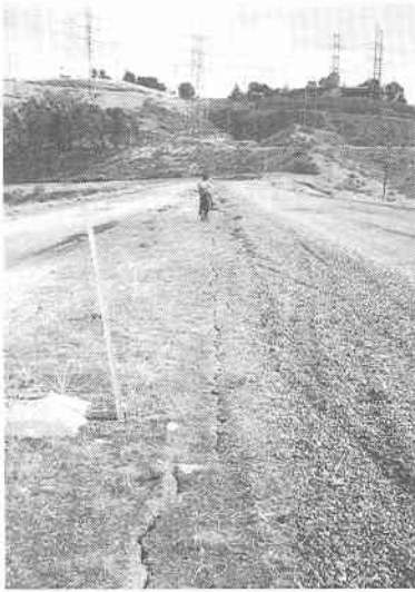
写真 7.3.7 サンフェルナンド下ダム天端中央付近の縦亀裂 (東京工大 大町達夫教授より提供)
