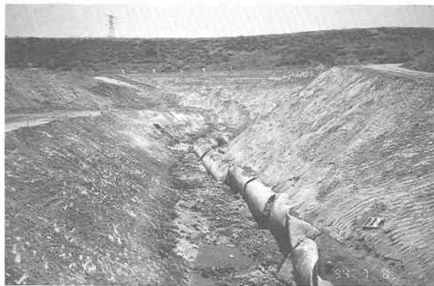
写真 7.3.11 サンフェルナンド下ダム法先付近の埋設コルゲート管の破損 (株)建設技術研究所 荒川昭治氏より提供)
