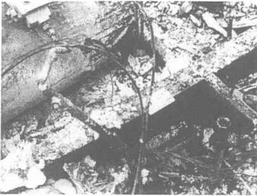
写真 10.2.1 モービルホームの切断されたガス管
