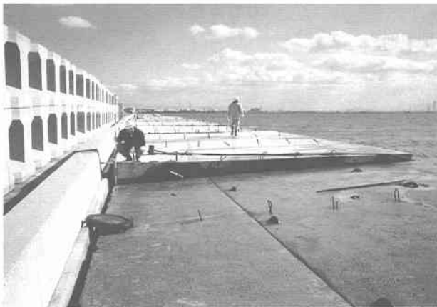
図-4.2.31 被災状況写真
