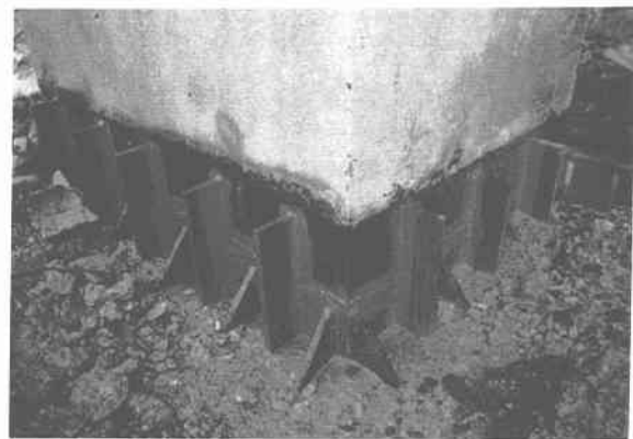
写真-5.4.8 鋼製橋脚基部の三角リブ上端部に生じた亀裂(溶接補修され矩形リブで補強されている)
