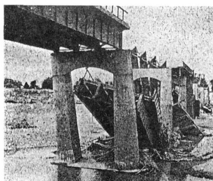
写真3 中角橋の落橋 17) (福井地震1948. 6. 28)
