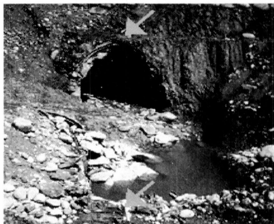
写真-5.2.4 断層変位による導水路トンネルの破壊 2)
