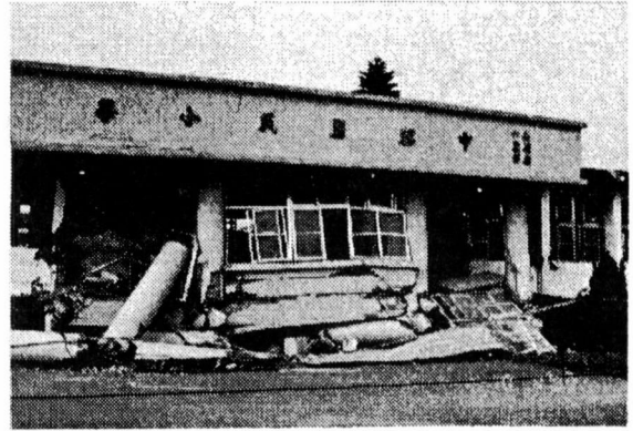
写真-5.2.5 中寮における低層RC建物の被害
