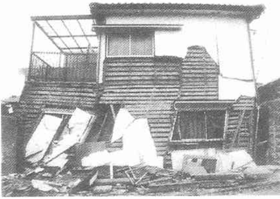
写真-3.2.3 木造家屋の被害 (文献6)より引用)
