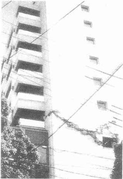
写真-3.2.5 RC造建物の被害 (文献7)より引用)
