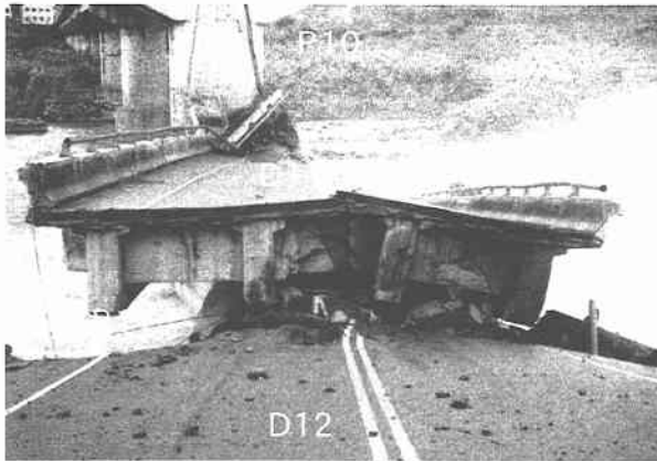
写真 13.7.1.3 卑豊橋 D11, D12, P11 の被害
