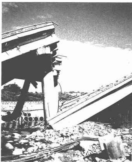
写真 13. 5. 4 P2 橋脚の橋軸方向への傾斜
