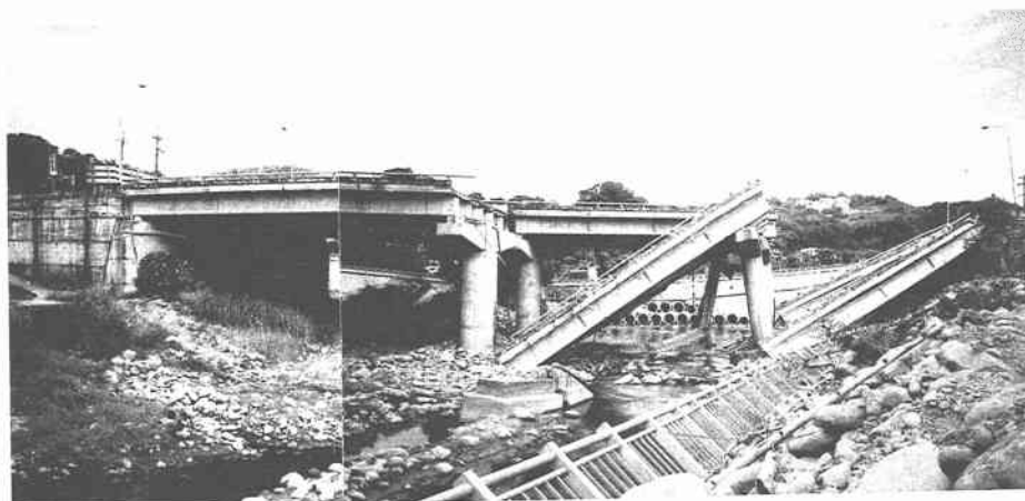
写真 13. 5. 1 石園橋の被害状況
