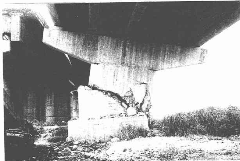
写真 13.6.1.5 新橋の P 2 橋脚の被害
