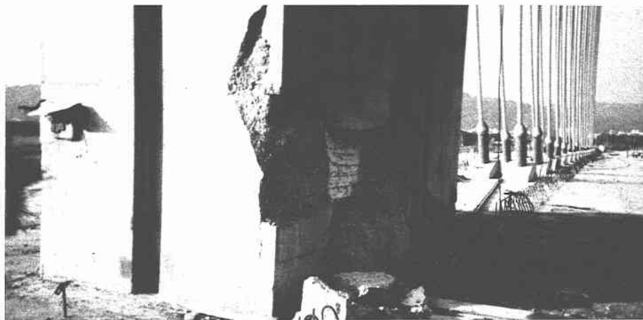
写真 13.2.1 集鹿大橋の被害
