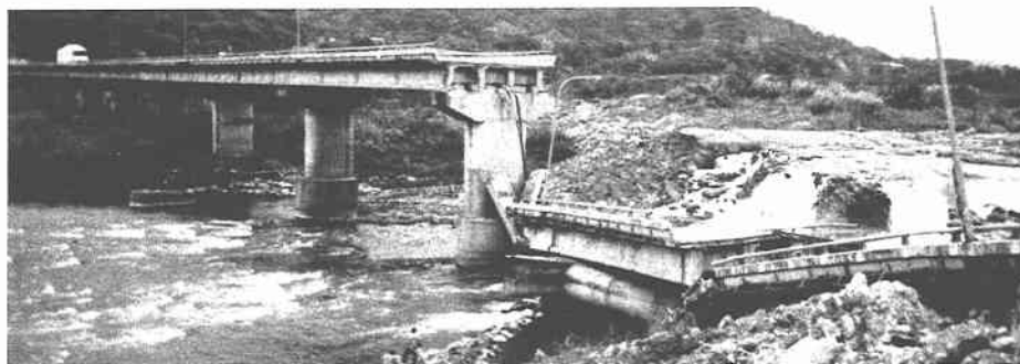
写真 13.2.2 卑豊橋の被害
