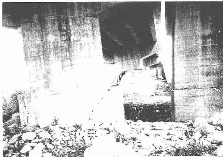
写真 13.6.1.6 新橋の P 3 橋脚の被害
