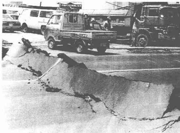
写真3. 7. 1-5 能代市河戸川県道における路面のバックリング(北羽新報社 1983)
