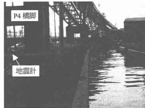
写真-1 境水道大橋周辺の被害状況
