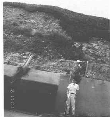
写真-1 道路擁壁の海側への転倒
