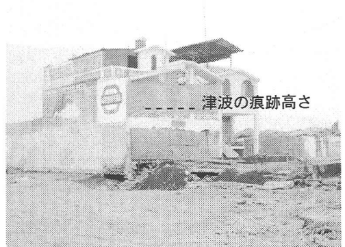
写真-1 La Punta における津波による建物被害例
