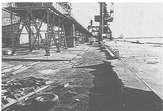
写真-1 a 2埠頭南岸壁-12m（対策無）
