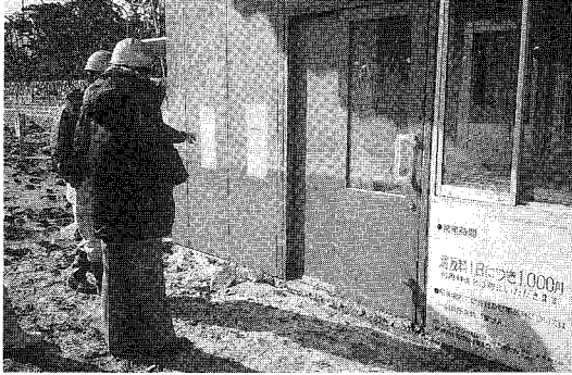
写真-1 料金所に残る泥水跡
