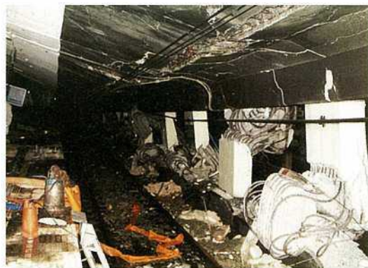
写真-3 ボックス断面開削トンネルの被害
