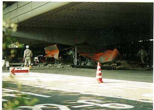
写真-7 崩壊した鋼橋脚
