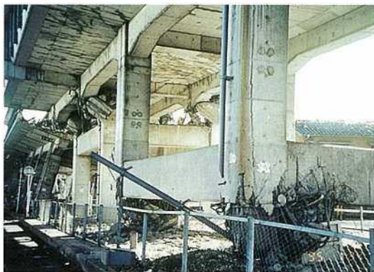
写真-2 新幹線二層ラーメン高架橋の崩壊
