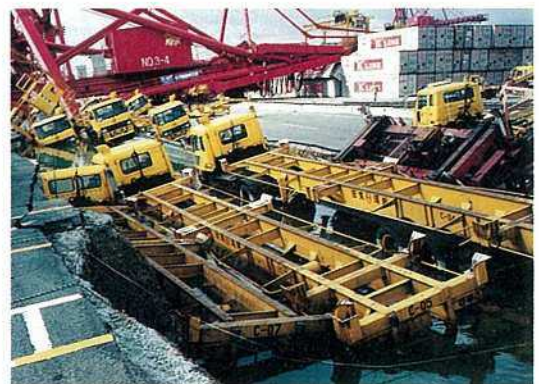
写真-5 コンテナ埠頭の被害
